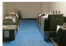
低濃度PCB保管風景
